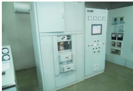
improvisado en casa de maquinas
