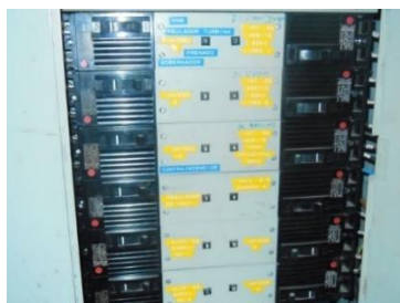
Panel DC a intercambiar
