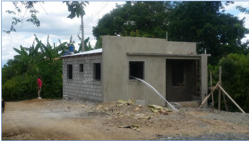
Pañete en fachada, casa del Sr. Aristeo Jiménez, Viviendas Económicas.
