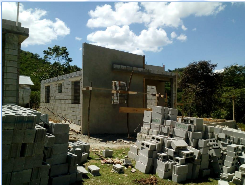
Pañete en fachada, casa del Sr. Ramón Ramírez, Viviendas Económicas.
