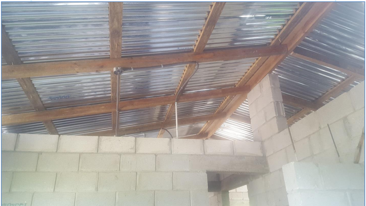
Instalaciones eléctricas, casa de la Sra. Reyita Solís, Viviendas Económicas.
