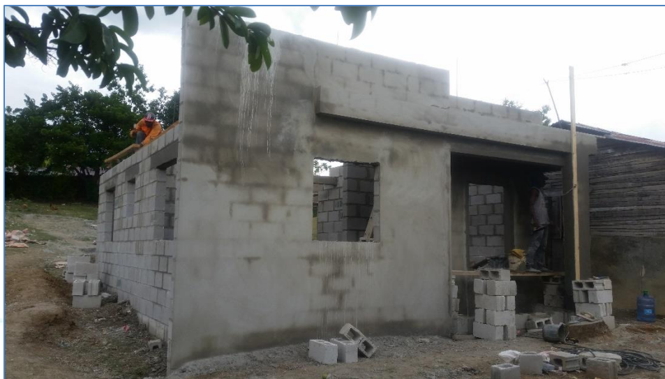
Pañete en fachada, casa del Sr. Isidoro Solis, Viviendas Económicas.
