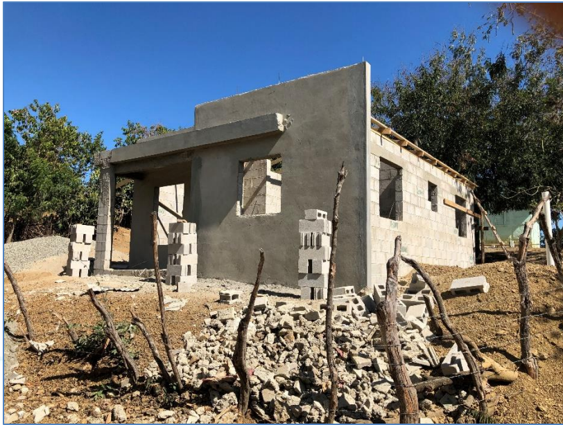
Pañete en fachada, casa del Sr. Álvaro Hernández, Viviendas Económicas.
