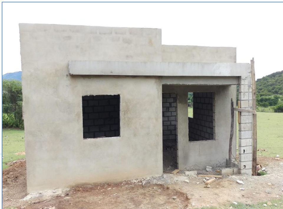
Pañete en fachada, casa del Sr. Antonio Suero, Viviendas Económicas.
