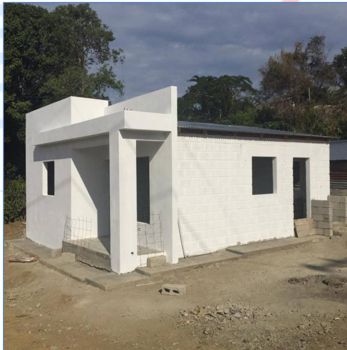
Aplicación de pintura base, casa de la Sra. Modestina Ramírez, Viviendas Económicas.
