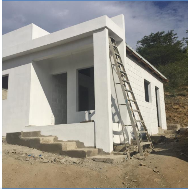
Aplicación de pintura base, casa de la Sra. Bienvenida Ramírez, Viviendas Económicas.
