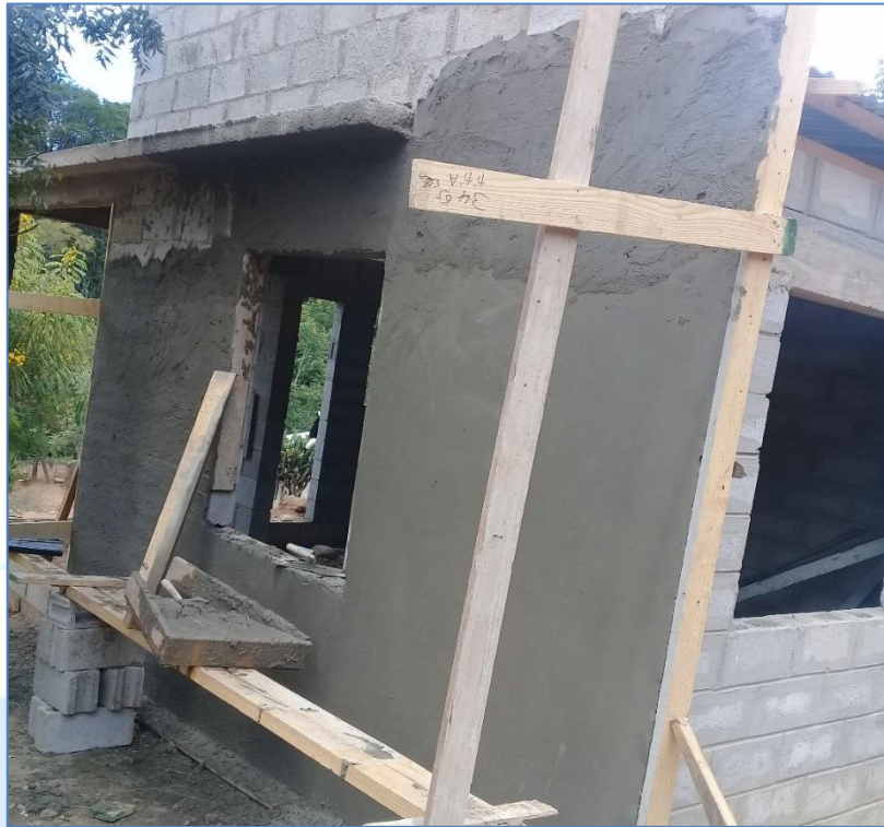
Pañete de fachada frontal, casa de la Sra. Santa Comas, Viviendas Económicas.
