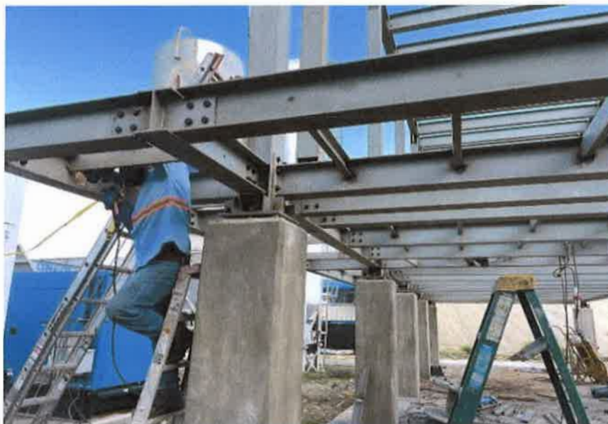
Estructura para planta de hielo
