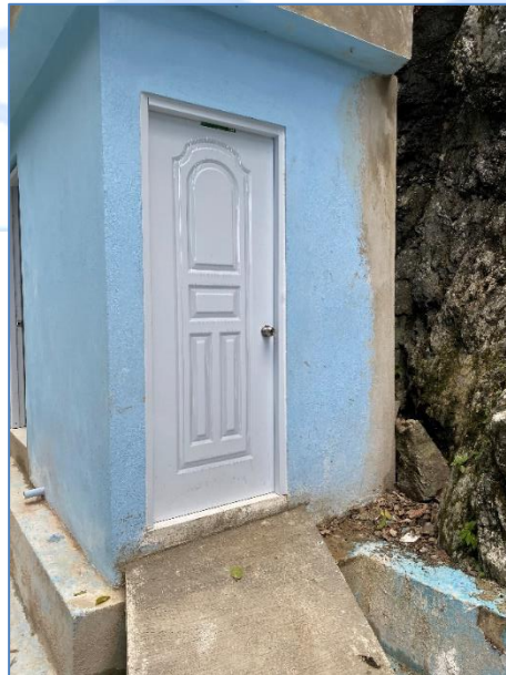
Baño para empleados, Central Hidroeléctrica Jimenoa.
