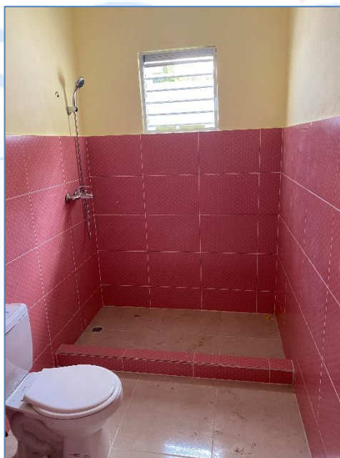
Cerámica en baños, Central Hidroeléctrica Jimenoa.
