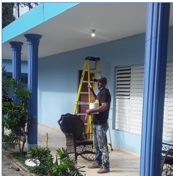
Pintura en techo y pared en casas de techo plano 1 y 2, Central Hidroeléctrica Jimenoa.
