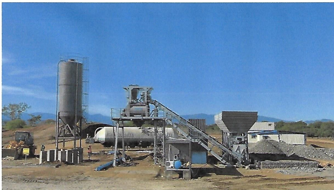
Planta de hormigón Eagler
