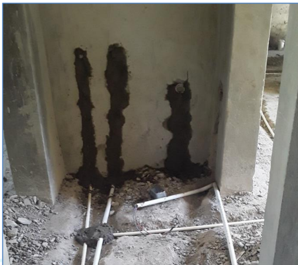
Instalaciones sanitarias, casas #1, #2 y #3, Central Hidroeléctrica Jimenoa.
