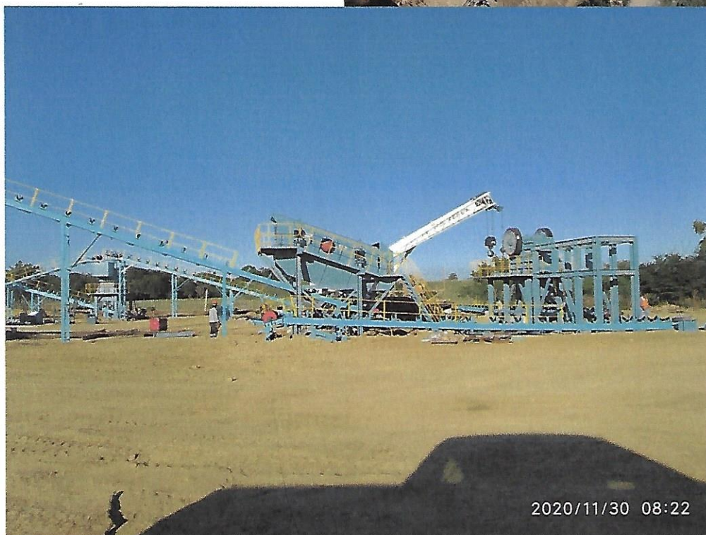
Vista Equipos de Plantas Industriales
