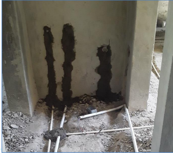
Instalaciones sanitarias, casas #1, #2 y #3, Central Hidroeléctrica Jimenoa.
