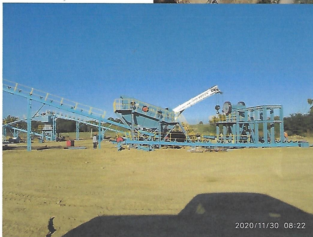
Vista Equipos de Plantas Industriales
