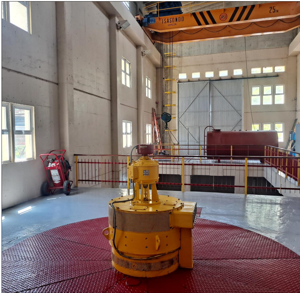
Figura N° 3. Vista del interior de la central hidroeléctrica
