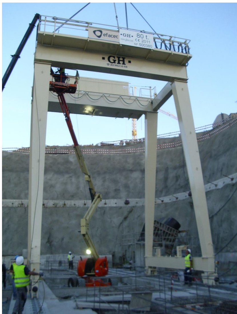
Figura N° 6. Ejemplo de pórtico grúa birrail
